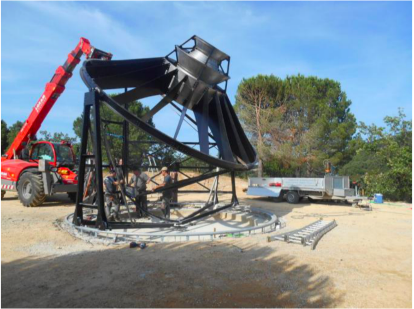
Figure 11 – Photographie des travaux en cours pur la reconstruction du four du Padre Himalaya, à Sorède. blog des Amis du padre Himalaya, himalaya.vefblog.net .
