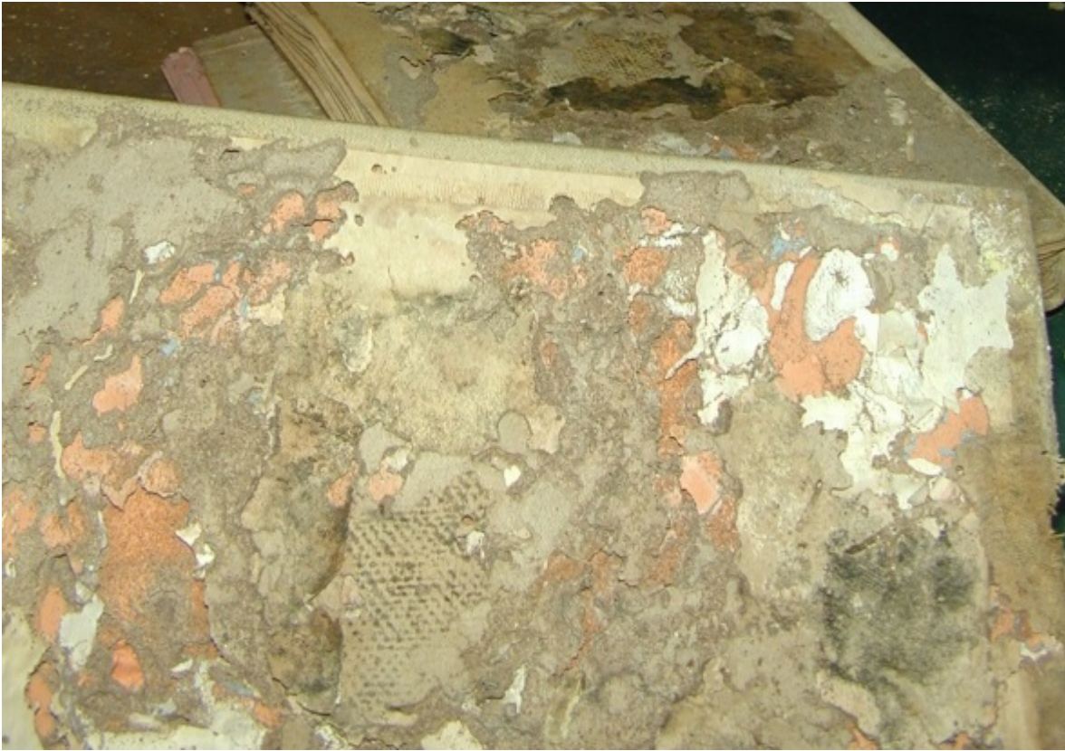
Faldoni archivistici danneggiati dalle termiti
