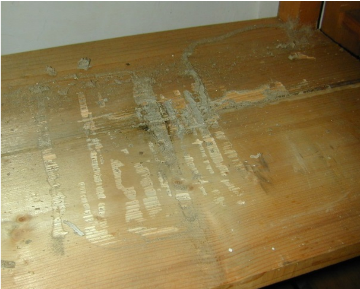
Scaffalatura lignea danneggiata dalle termiti
